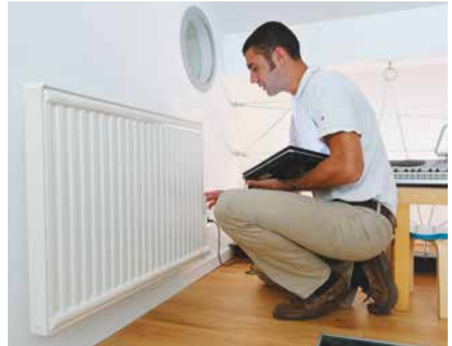
Les radiateurs de cet appartement sont alimentés par de l'eau chaude provenant d'un réseau de chaleur.
