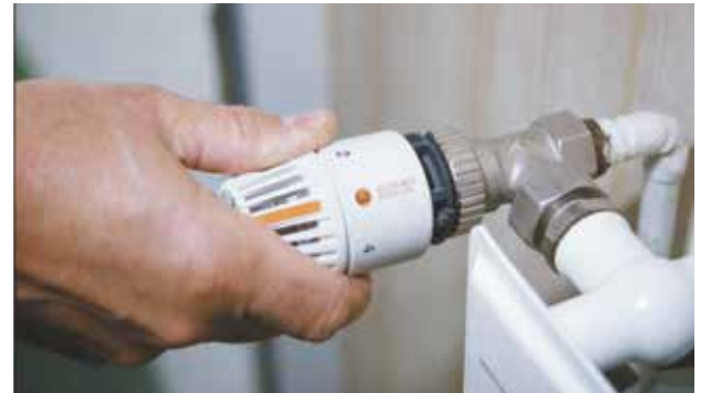
Grâce à un robinet thermostatique, vous pouvez limiter ou couper l'arrivée d'eau chaude et réguler votre chauffage.
